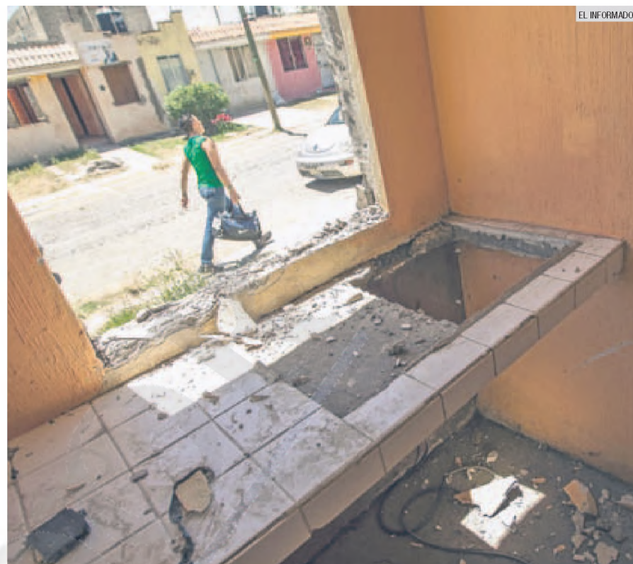
TLAJOMULCO. La Zona Valles es la más afectada por el fenómeno de casas abandonadas o deshabitadas.
