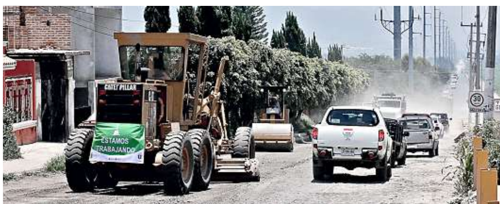
■ La carpeta asfáltica que se está instalando en la Carretera Nextipac-La Venta del Astillero podrá soportar cargas de más de 70 toneladas.
